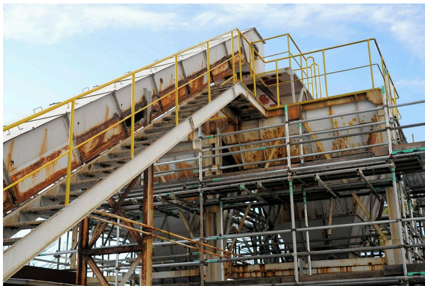
焼却灰を運ぶコンベヤーは穴が開き、さび付いていた塩釜市清掃工場=2026年3月10日午後3時32分、宮城県塩釜市杉ノ入裏、浅田朋範撮影
