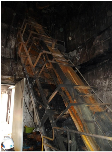
「破碎物排出コンベヤ」中層部(7/18 16:30更新)
