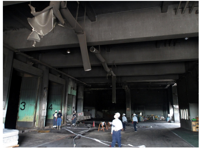
「ごみ焼却施設：プラットホーム」火災の熱で溶けたダクトが天井から垂れ下がっている様子が確認できる。(7/18 16:30更新)
