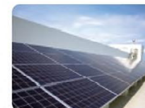
太陽光発電パネル(大田清掃工場)
