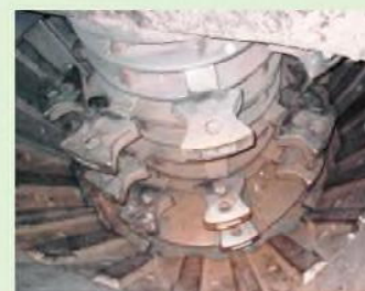
破碎機の内部
