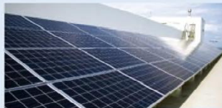
太陽光発電パネル(大田清掃工場)
