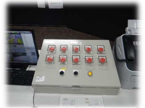
非常停止ボタン
