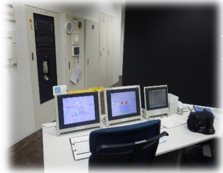
クレーン操作パネル
