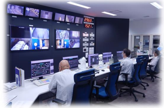
中央制御室の様子
