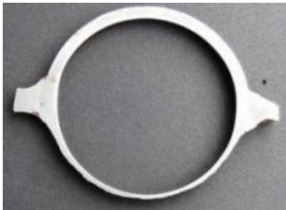
厚みの減った水管断面
