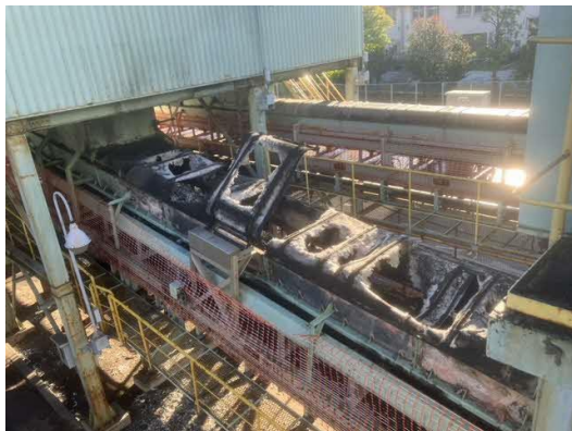
写真1 排出コンベヤ(3)
