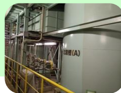
(汚水処理設備)
