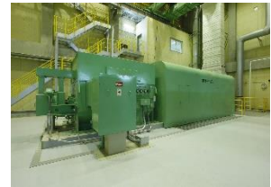
蒸気タービン発電機
