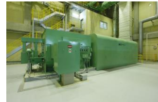
蒸気タービン発電機
