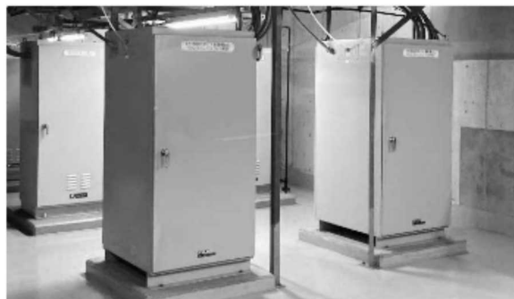
排ガス分析計（板橋清掃工場）
