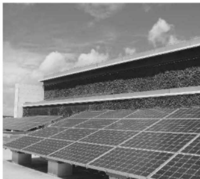
太陽光パネル (大田清掃工場)
