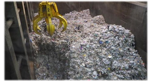
ごみバンカとごみクレーン
