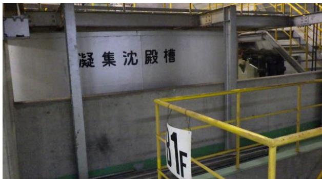
汚水処理設備
