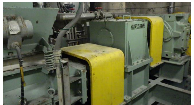
飛灰処理設備
