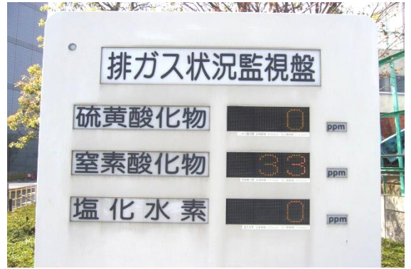
排ガス状況監視盤
