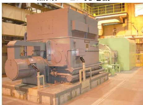
蒸気タービン発電機
