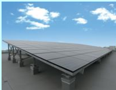
太陽光パネル
