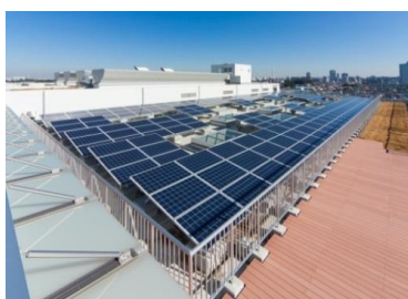
太陽光パネル
