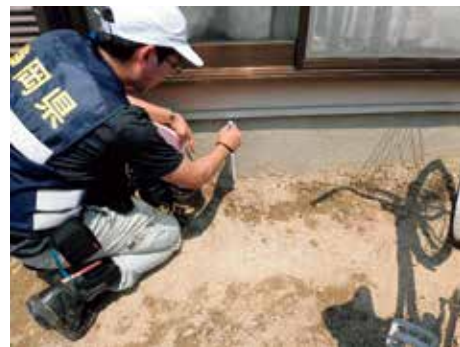
応援職員による住家の被害状況調査
