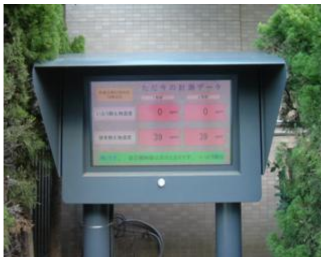
【排ガス状況表示盤】
