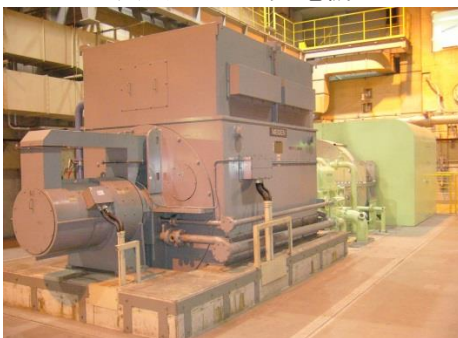
蒸気タービン発電機
