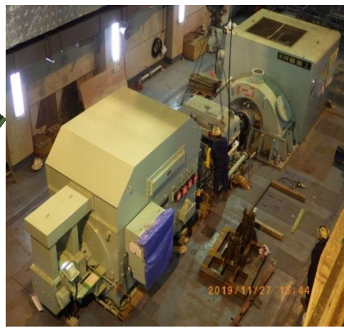
<発電機更新後>
