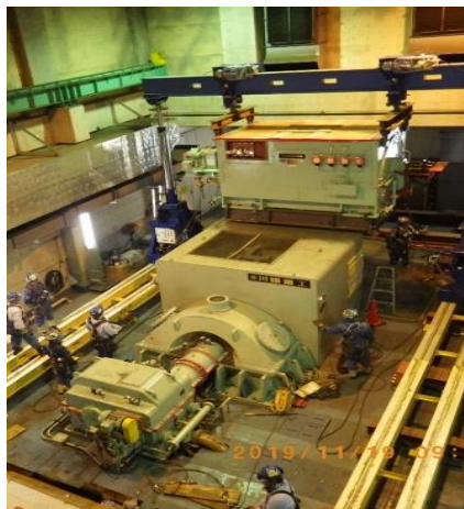
<発電機更新前>
