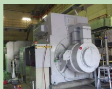
蒸気タービン発電機
